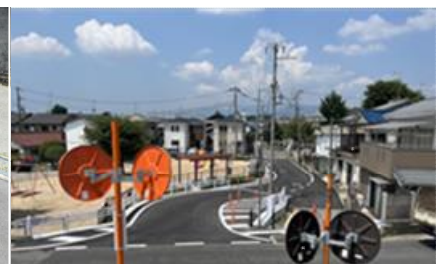
D10/三葉公園工事・市道57号道路改良工事 【令和5年度完成】
